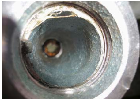
Avant installation Aqua-4D®
