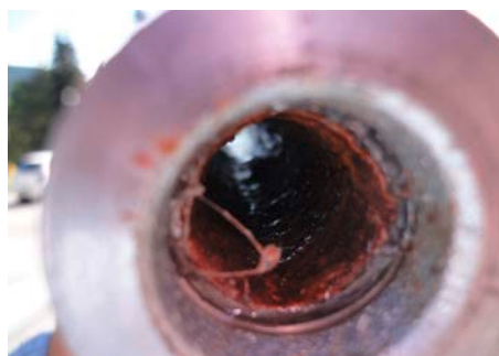
Avant installation Aqua-4D®
