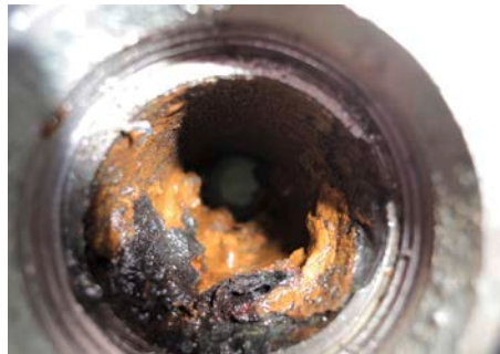
Avant installation Aqua-4D®
