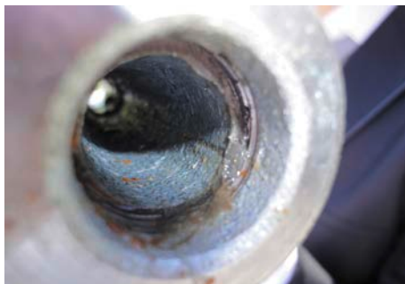
Avant installation Aqua-4D®
