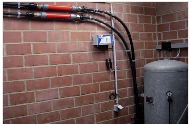
Abbildung 8: Installation in einem Viehzuchtbetrieb in Cloppenburg (03/2007)
