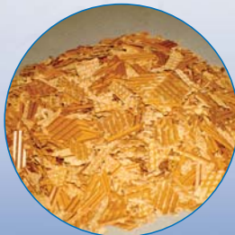
Kalk in einem Wärmetauscher
